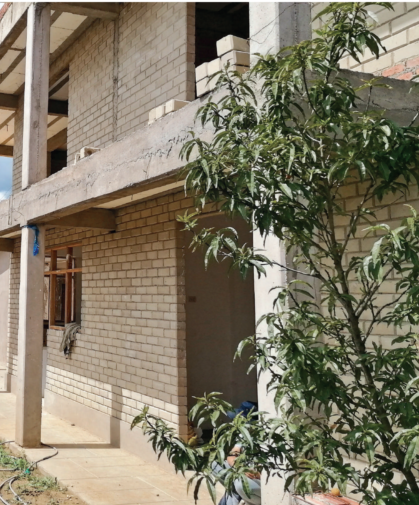
Obra gruesa del proyecto piloto de vivienda bioclimática con paredes de BTC
